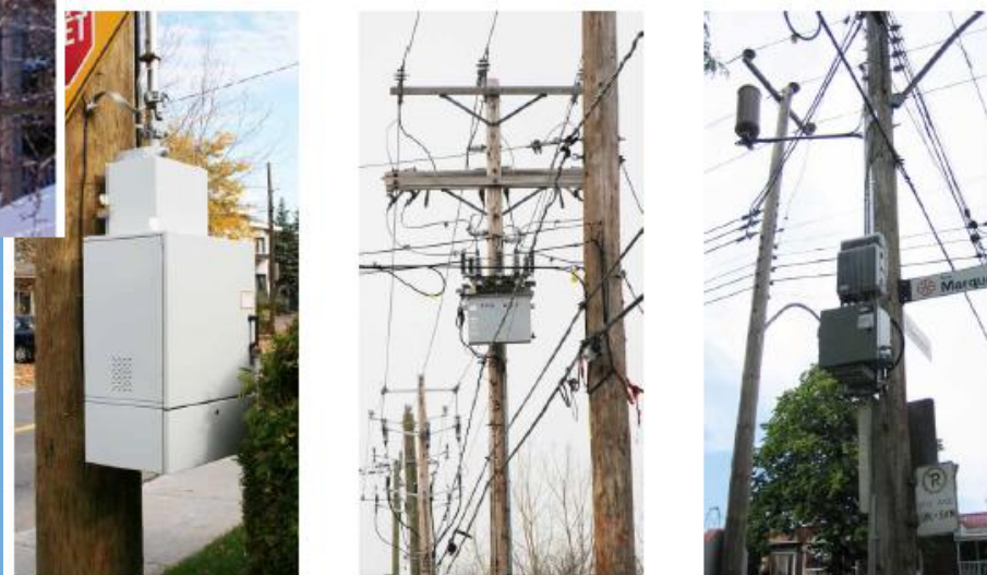
Équipements sur poteau
